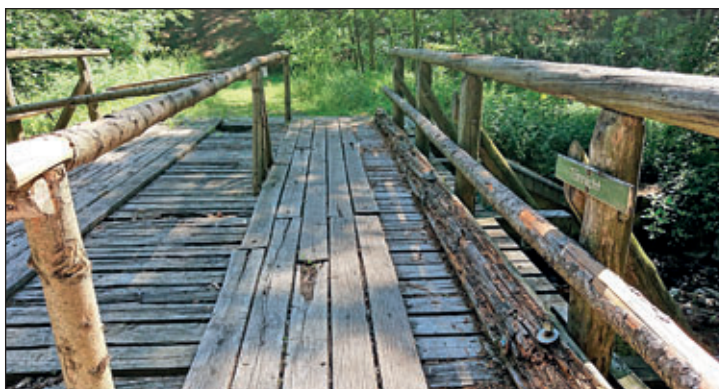
Defekte Brücke – auf eigene Gefahr!
