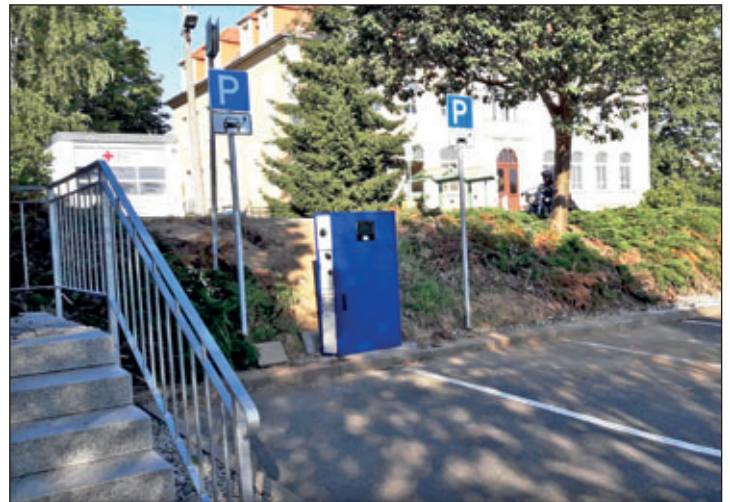
FOTO: E-Ladestation Parkplatz Schulstraße in Dorfhain
